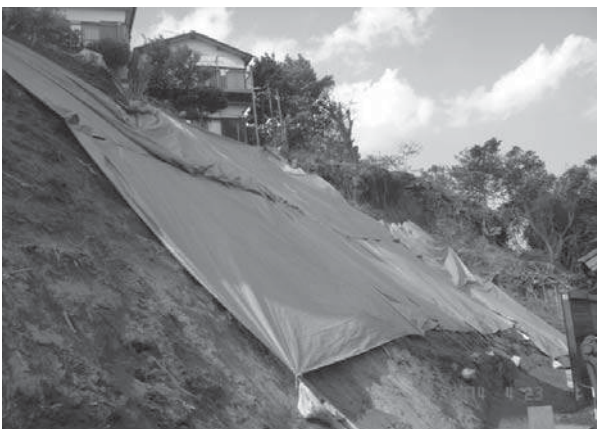
3.11で崩落した被災現場
